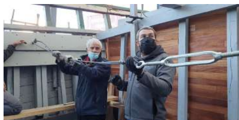
Cable de acero con los tensores
